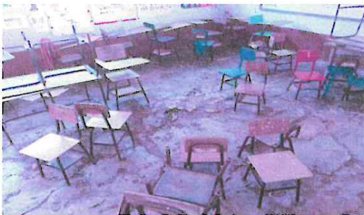
Foto 3: Torta en mal estado Aula 1
