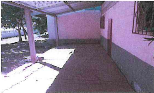
Foto 1: Estado actual de las paredes
