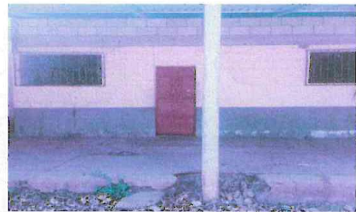
Foto 2: Estado actual de las paredes
